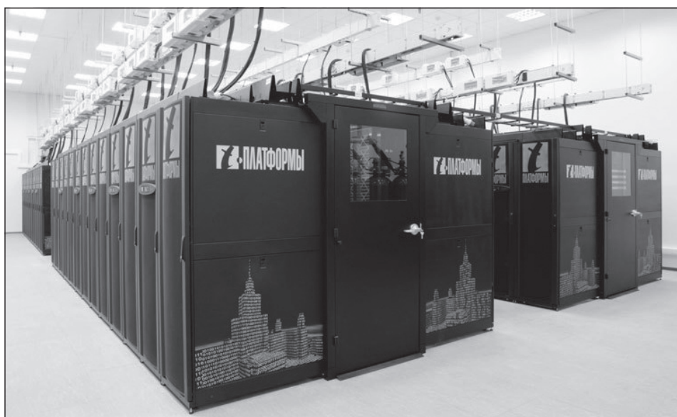
Фото 3. Суперкомпьютер «Ломоносов» (источник фото: http://www.t-platforms.ru/solutions/completed/lomonosov-supercomputer )
